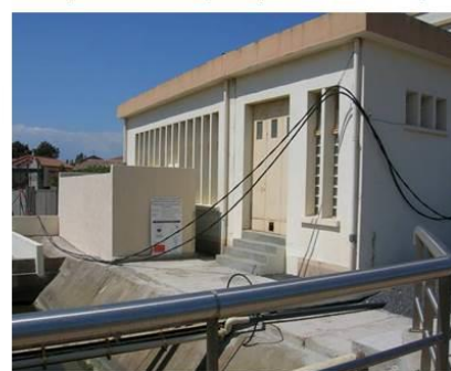
Station de pompage du Gourp Sallat http://www.vallee-orb.fr
